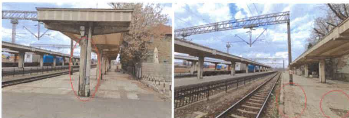
Figura 4-69. Gara Bacău – elemente ce necesită reparații
